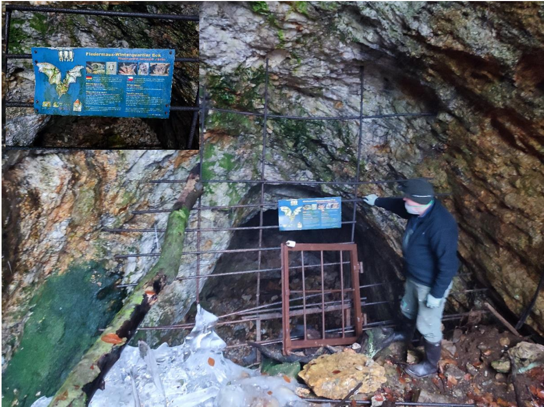
Abb. 40: Stollenverschluss, aktuell (2024) beschädigt (Foto: Mayer)
