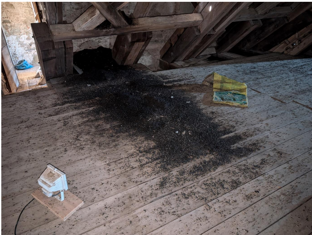
Abb. 9: Kot unter dem Hangplatz im Seitenschiff (Foto: Mayer)
