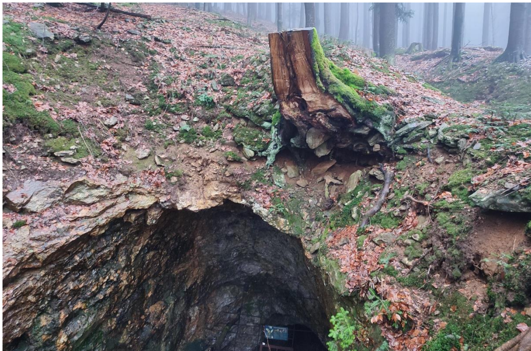
Abb. 41: Die Absperrung wurde durch eine Baumfällung beschädigt (Foto: Mayer)
