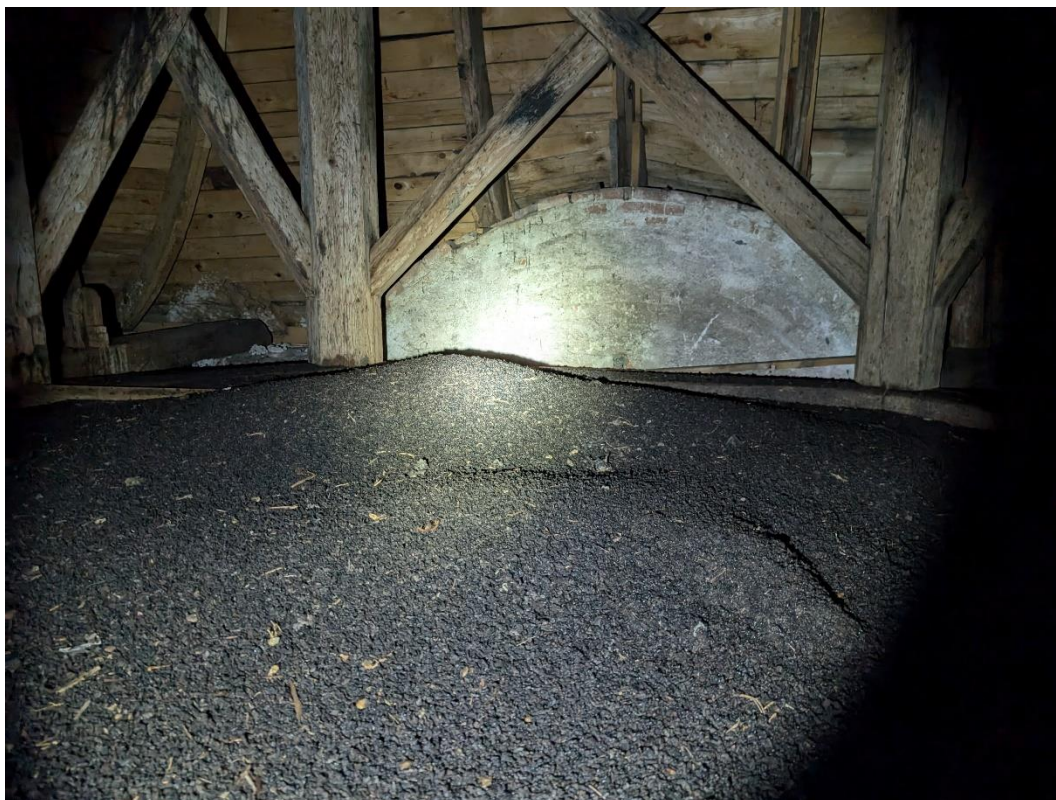
Abb. 28: Alte Kothaufen im Turm (Foto: Mayer)
