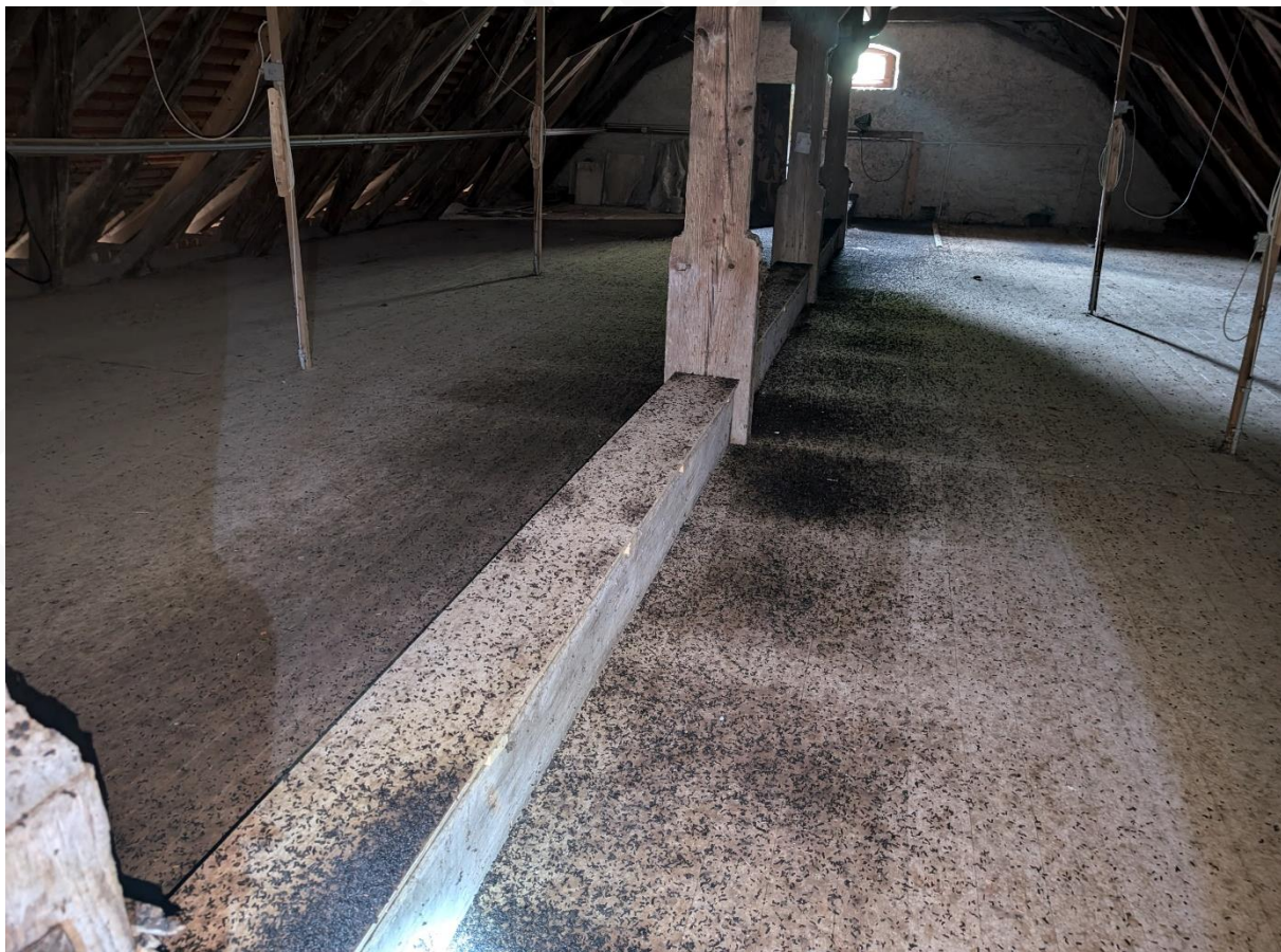
Abb. 19: Kot über das gesamte Langschiff verteilt (Foto: Mayer)
