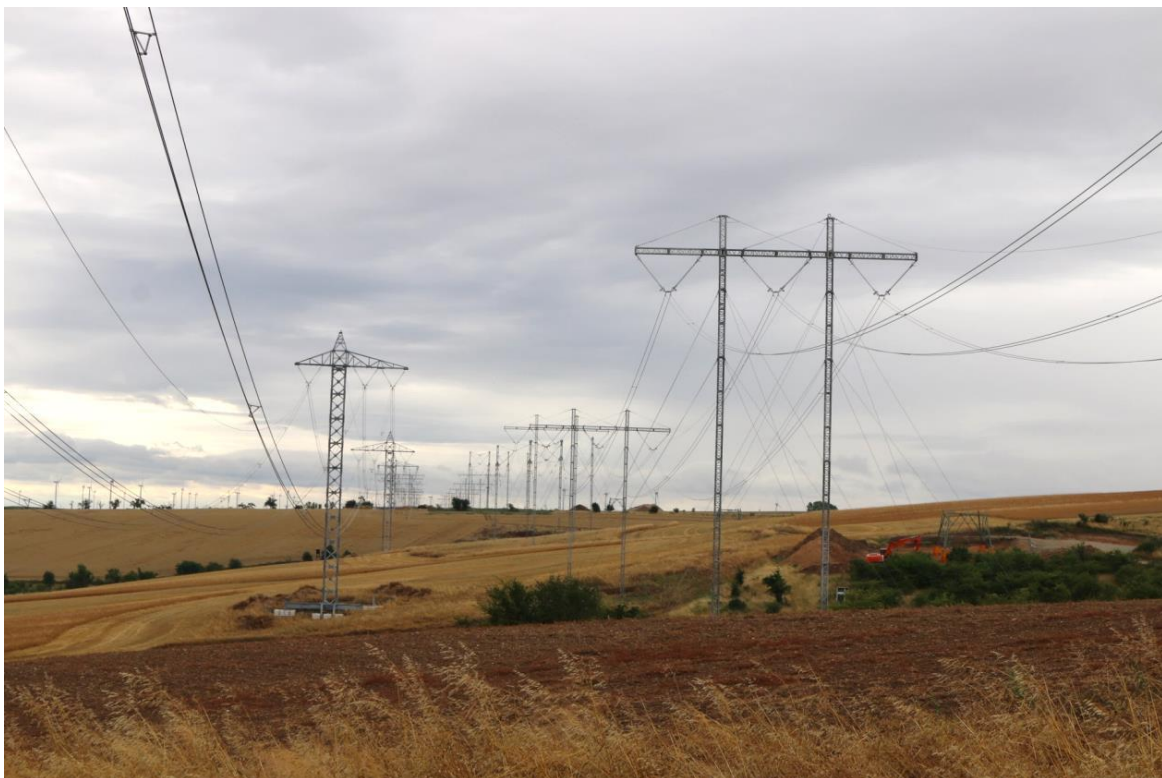
Abbildung 13: 380-kV-Freileitungsprovisorium für zwei 380-kV-Stromkreise
