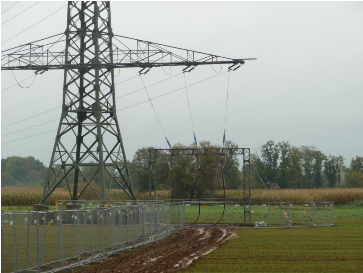
Abbildung 15: 110-kV-Kabelprovisorium mit Übergangportal
