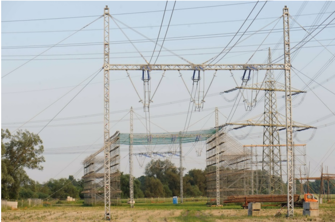
Abbildung 13: 380-kV-Freileitungsprovisorium für ein System mit errichtetem Schutzgerüst
