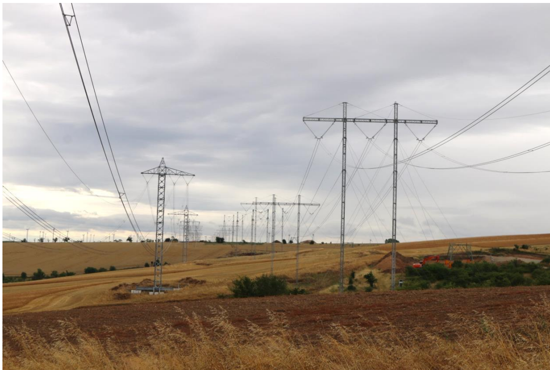
Abbildung 13 Abbildung 41 : 380-kV-Freileitungsprovisorium für zwei 380-kV-Stromkreise
