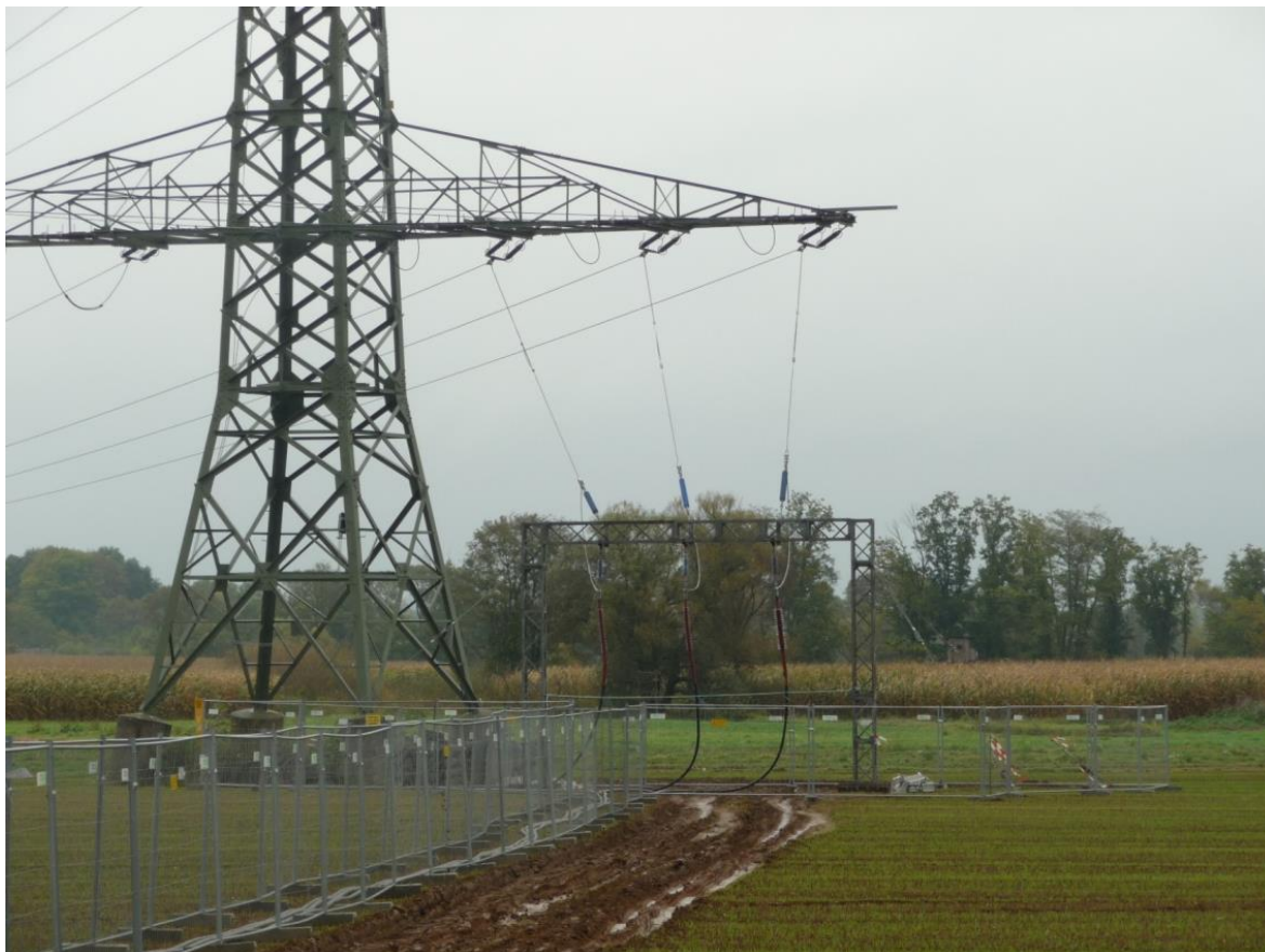
Abbildung 15 Abbildung 43 : 110-kV-Kabelprovisorium mit Übergangsportal
