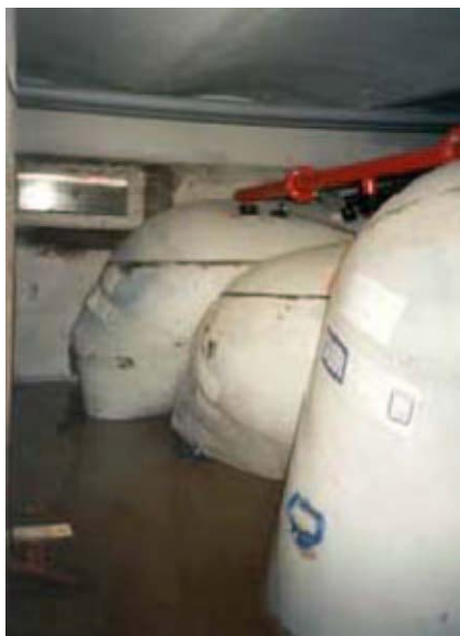
Durch Wasserauftrieb losgerisene und ausgelaufene Heizöltanks
